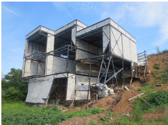
Рис. Строительство частного дома на ул. Волжской (б. Рыбацкая) в г. Чебоксары заморожено в связи с оползневыми деформациями (2016 г.)
